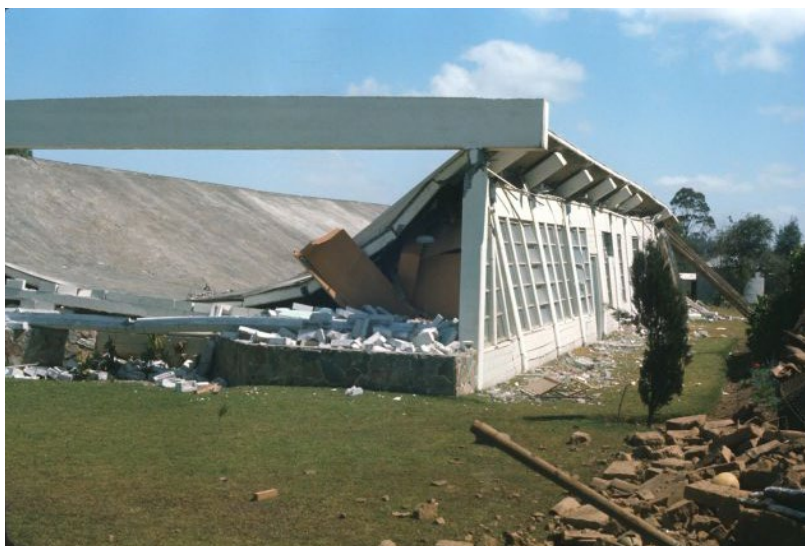
Capilla de Patzicía, Guatemala, después del terremoto de 1976
