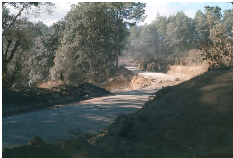
Mientras salíamos de Comalapa, algunos tramos del camino todavía se estaban desprendiendo y deslizando hacia los barrancos.
