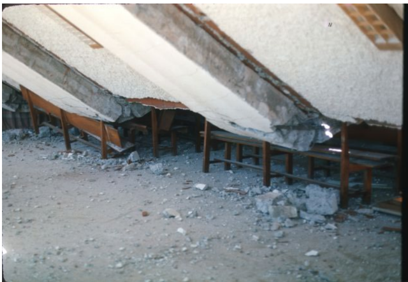
Bancos aplastados en la capilla
