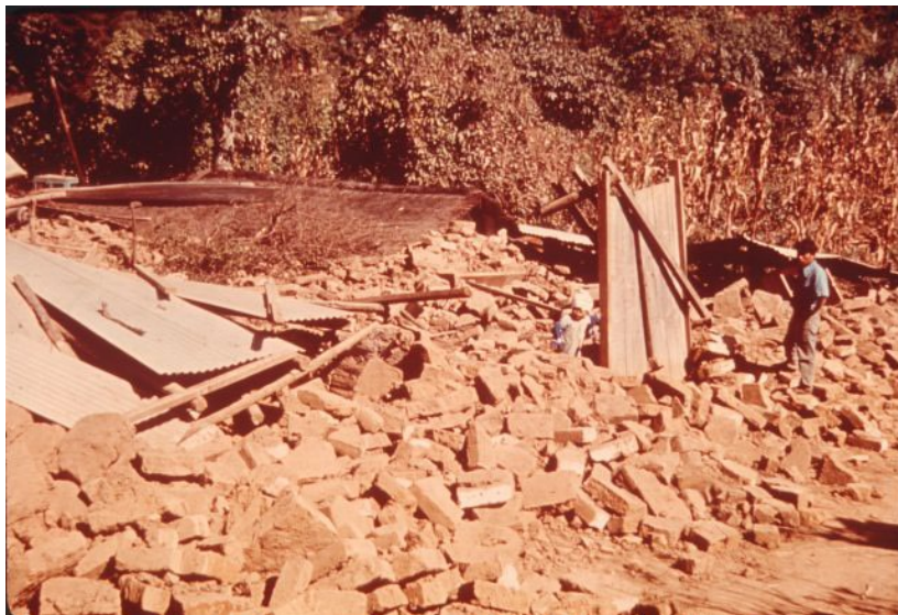
Restos de la casa de Pablo Choc tras el terremoto. Solo queda en pie la puerta en medio del muro exterior derrumbado.
