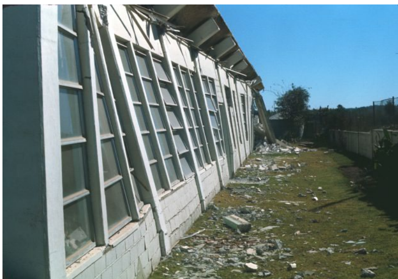
Capilla de Patzicía, Guatemala, después del terremoto de 1976
