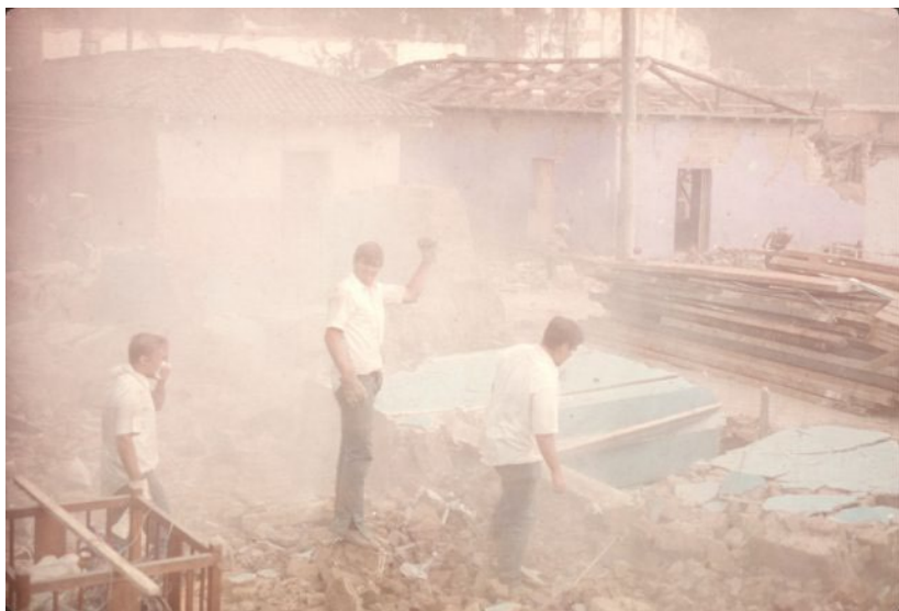
Y la pared se derrumbó
